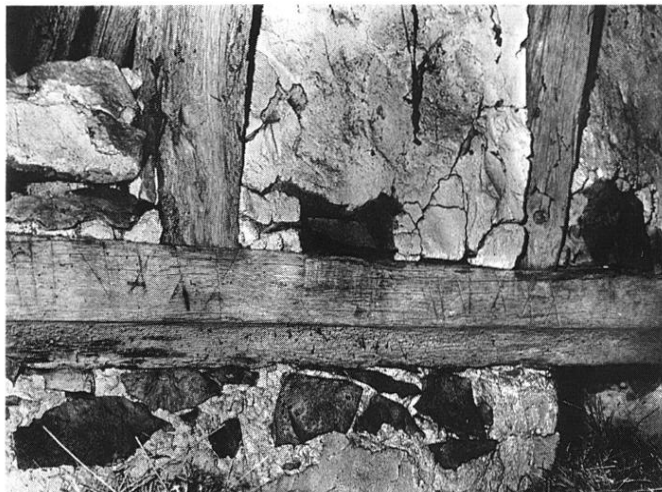
Fig. 22 Charpente- Pieds de fermes à l'ouest et marques sur la sablière (Ph. D. Bontemps Cl. M. H.)
