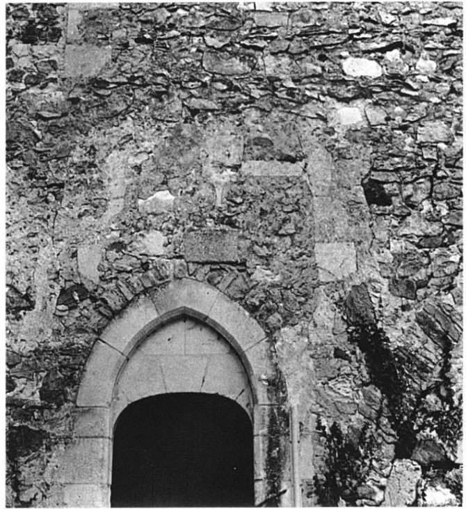
Fig. 18 Façade orientale au sud. Dernière porte-Trace de baie. (Ph. D. Bontemps Cl. M. H.)
