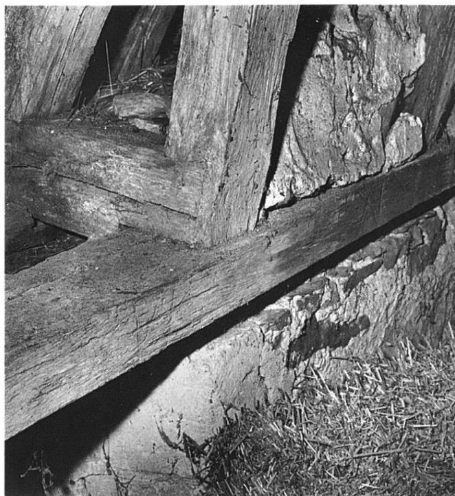
Fig. 25 Charpente- Pied d'une ferme secondaire et marques sur la sablière. (Ph. D. Bontemps Cl. M. H.)
